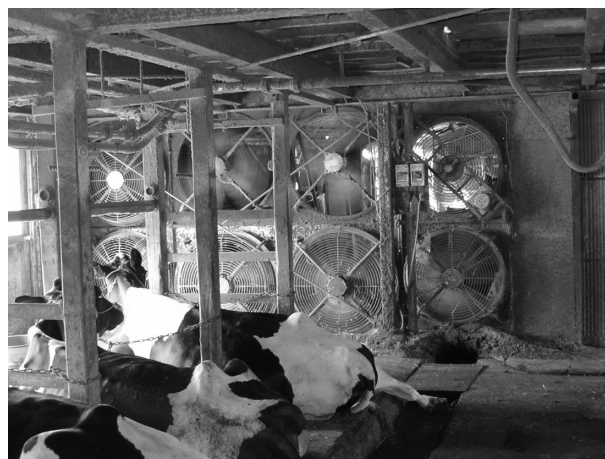
写真8 既設のファンも組み合わせて使用し初期コストを抑える
